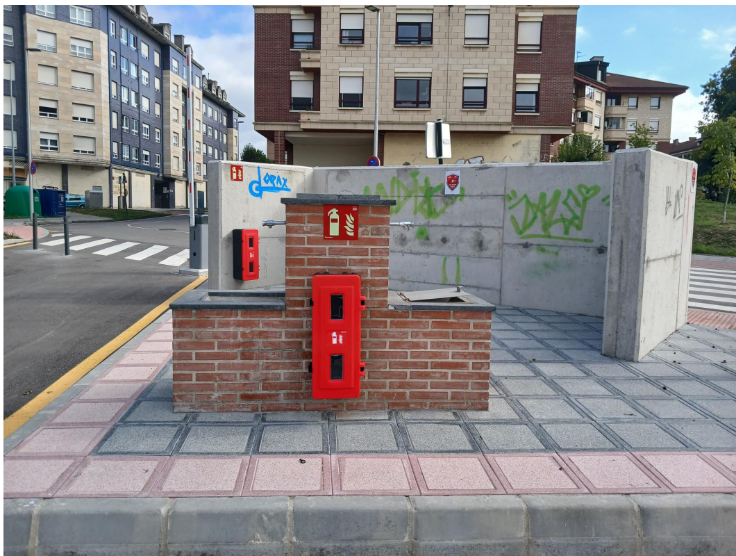
EXTINTORES DENTRO DE CAJAS SOPORTE
