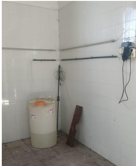
Figura 41. Bomba cloración automática ETAP La Collada
