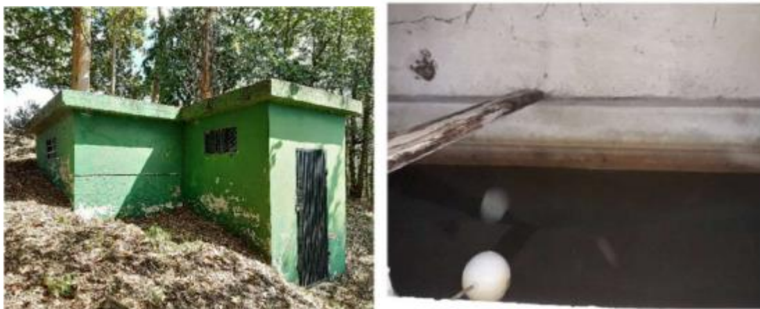
Figura 88. Depósito Tablao. Fuente: Informe TRAGSA "Servicio técnico de auditoría a los sistemas de abastecimiento en baja de los municipios de Noreña, Gozón y Siero"
