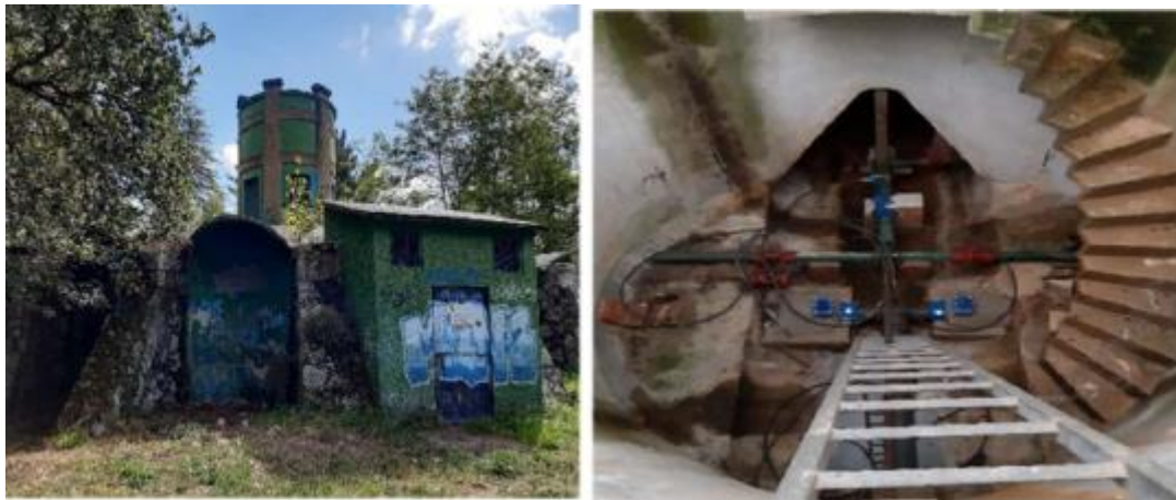
Figura 63. Depósito Carbayu. Fuente: Informe TRAGSA "Servicio técnico de auditoría a los sistemas de abastecimiento en baja de los municipios de Noreña, Gozón y Siero"
