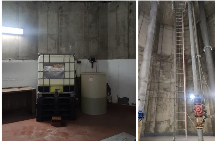
Figura 86. Cloración y acceso a la lámina de agua depósito Fresneda II
