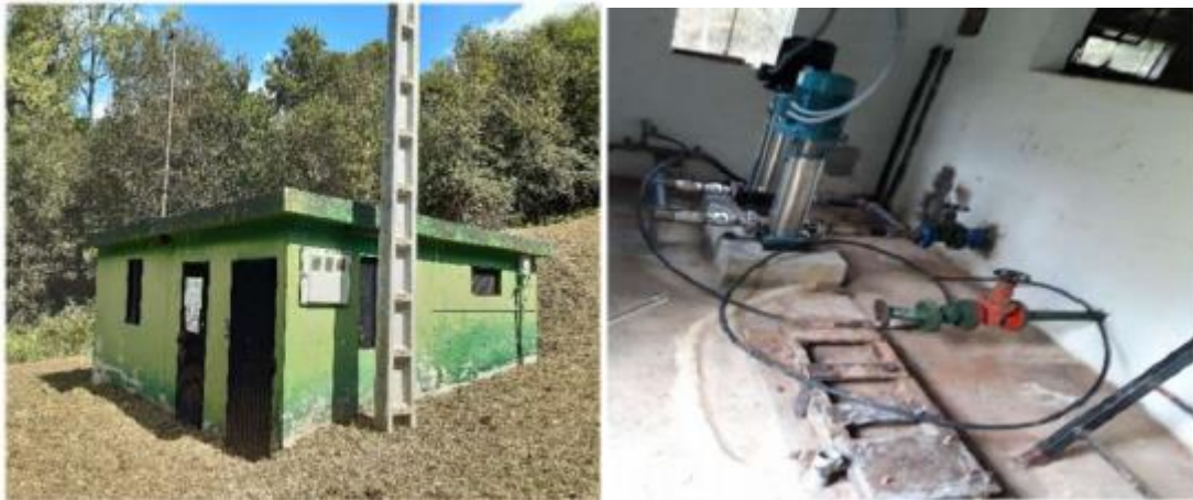
Figura 87. Depósito y Bombeo Tablao. Fuente: Informe TRAGSA "Servicio técnico de auditoría a los sistemas de abastecimiento en baja de los municipios de Noreña, Gozón y Siero"
