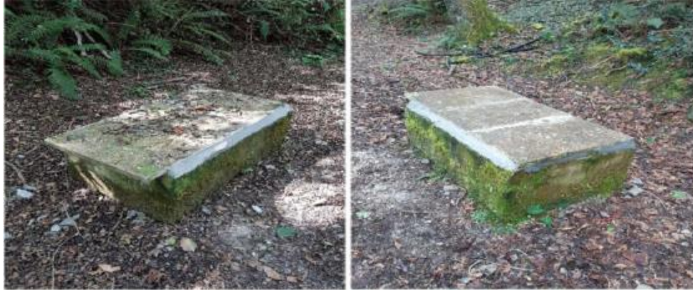
Figura 32. Sondeo Molledo. Fuente: Informe TRAGSA “Servicio técnico de auditoría a los sistemas de abastecimiento en baja de los municipios de Noreña, Gozón y Siero”
