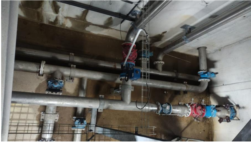
Figura 62. Tubería de entrada CADASA y reparto a los vasos Granda II
