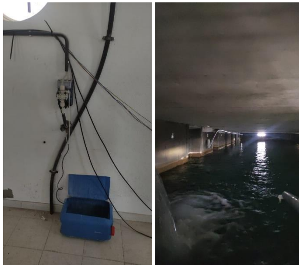
Figura 59. Dosificación hipoclorito (izq.) y lámina de agua (dcha.) depósito Granda I
