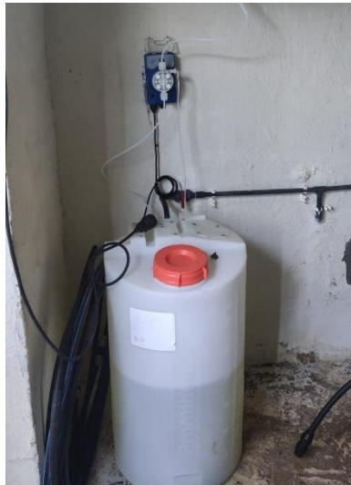
Figura 68. Bombas dosificación de cloro Piqueru
