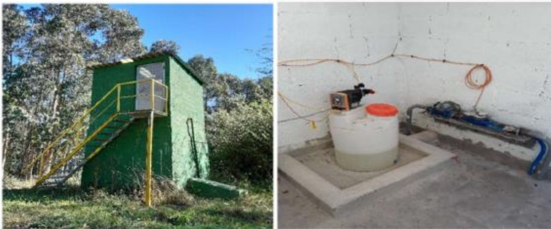
Figura 91. Depósito Ruedes. Fuente: Informe TRAGSA "Servicio técnico de auditoría a los sistemas de abastecimiento en baja de los municipios de Noreña, Gozón y Siero"
