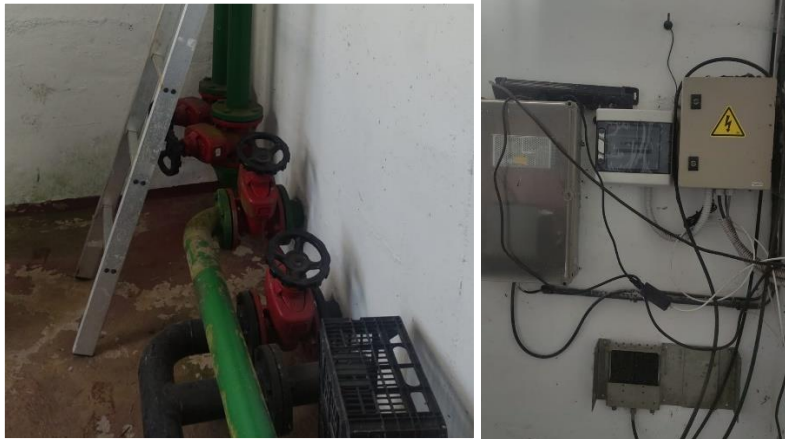
Figura 48. Entrada agua (izq.) y cuadro eléctrico (dcha.) depósito Muncó
