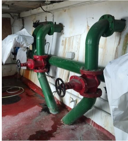
Figura 56. Tubería de entrada de CADASA y reparto a los vasos
