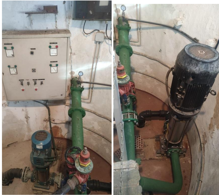
Figura 75. Bombeo depósito Areñes
