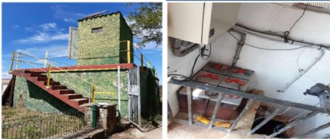
Figura 90. Depósito Pañeda. Fuente: Informe TRAGSA "Servicio técnico de auditoría a los sistemas de abastecimiento en baja de los municipios de Noreña, Gozón y Siero"
