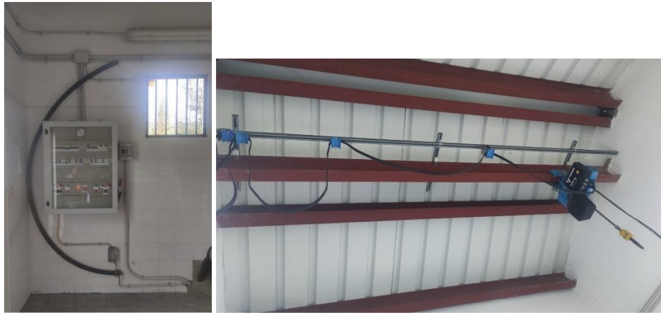
Figura 35. Cuadro eléctrico y polipasto bombeo La Collada
