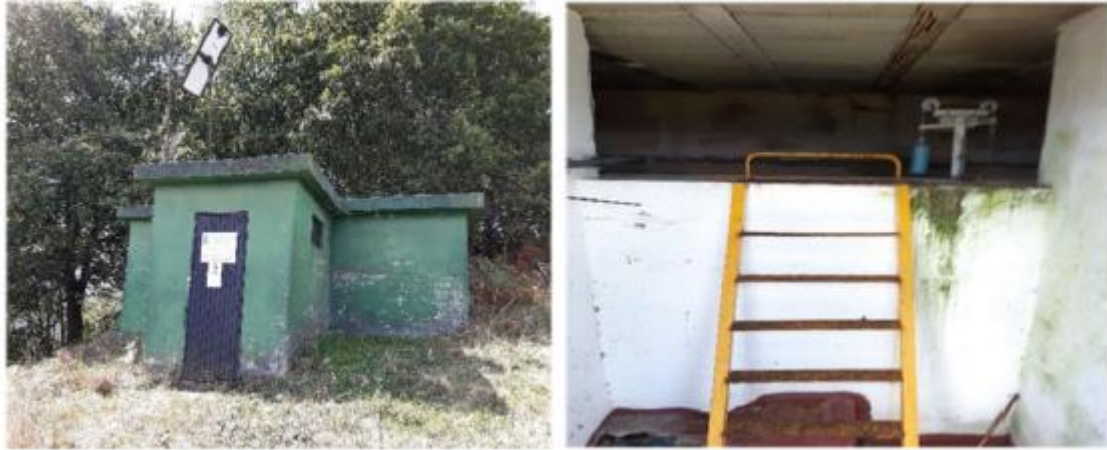
Figura 89. Depósito Caballeros. Fuente: Informe TRAGSA "Servicio técnico de auditoría a los sistemas de abastecimiento en baja de los municipios de Noreña, Gozón y Siero"
