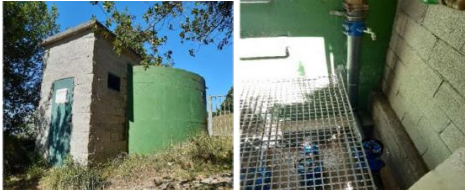
Figura 52. Depósito Lavandera. Fuente: Informe TRAGSA “Servicio técnico de auditoría a los sistemas de abastecimiento en baja de los municipios de Noreña, Gozón y Siero”
