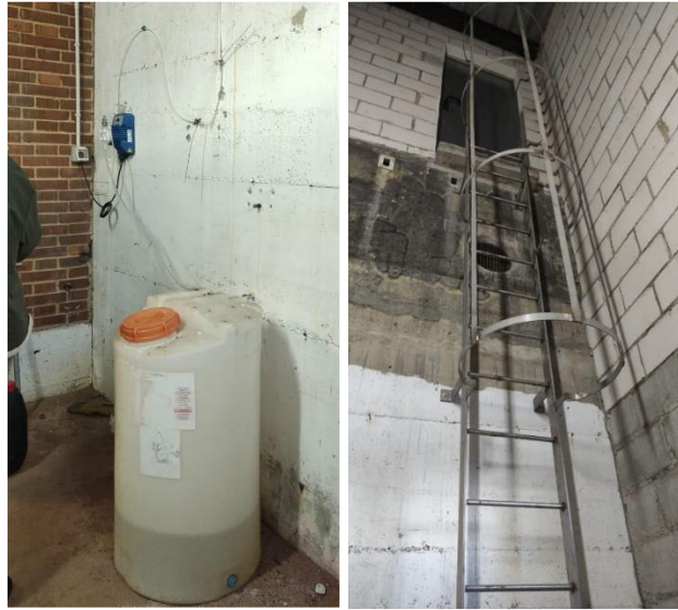
Figura 84. Cloración y acceso a la lámina de agua depósito Fresneda I
