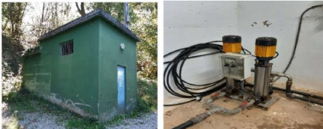
Figura 93. Depósito y Bombeo de Palmiano. Fuente: Informe TRAGSA “Servicio técnico de auditoría a los sistemas de abastecimiento en baja de los municipios de Noreña, Gozón y Siero”
