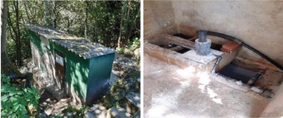
Figura 81. Depósito Rosellón. Fuente: Informe TRAGSA "Servicio técnico de auditoría a los sistemas de abastecimiento en baja de los municipios de Noreña, Gozón y Siero"
