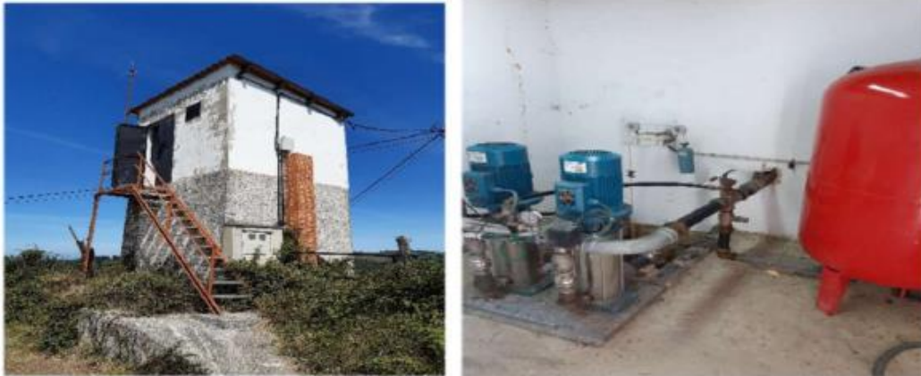
Figura 92. Depósito Varé Fuente: Informe TRAGSA “Servicio técnico de auditoría a los sistemas de abastecimiento en baja de los municipios de Noreña, Gozón y Siero”
