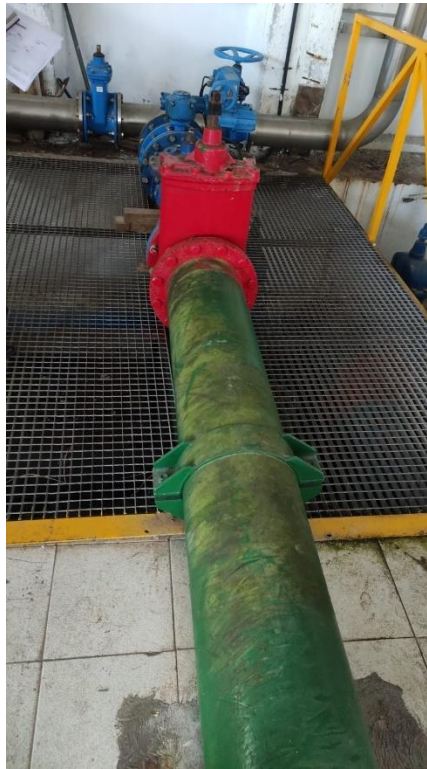
Figura 60. Tubería entrada CADASA a depósito Granda I
