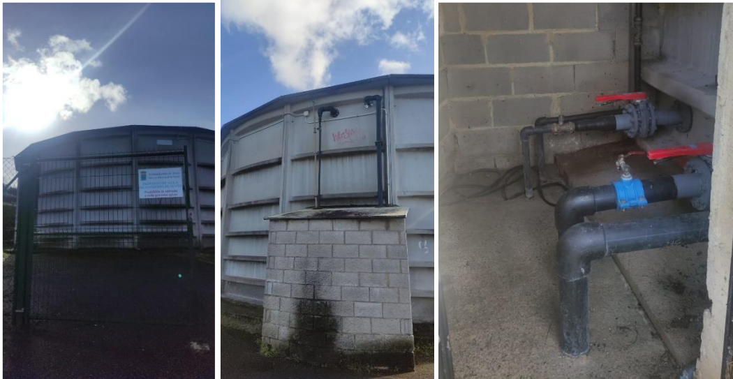
Figura 95. Depósito La Collada
