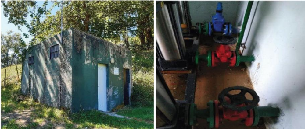
Figura 46. Depósito La Cabaña. Fuente: Informe TRAGSA "Servicio técnico de auditoría a los sistemas de abastecimiento en baja de los municipios de Noreña, Gozón y Siero"
