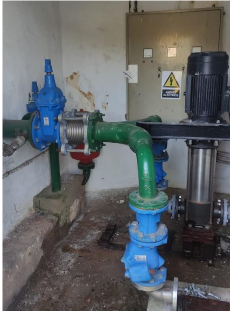
Figura 70. Bombeo a depósito Cerezales
