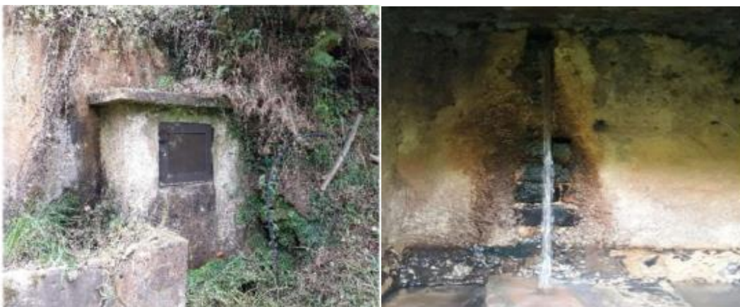
Figura 18. Manantial Tablao III. Fuente: Informe TRAGSA "Servicio técnico de auditoría a los sistemas de abastecimiento en baja de los municipios de Noreña, Gozón y Siero"
