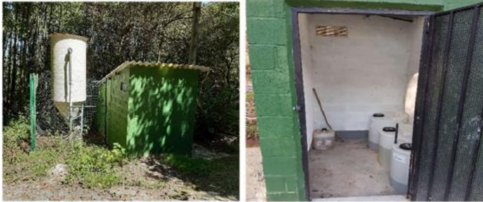
Figura 39. ETAP de Molledo. Fuente: Informe TRAGSA "Servicio técnico de auditoría a los sistemas de abastecimiento en baja de los municipios de Noreña, Gozón y Siero" 2025
