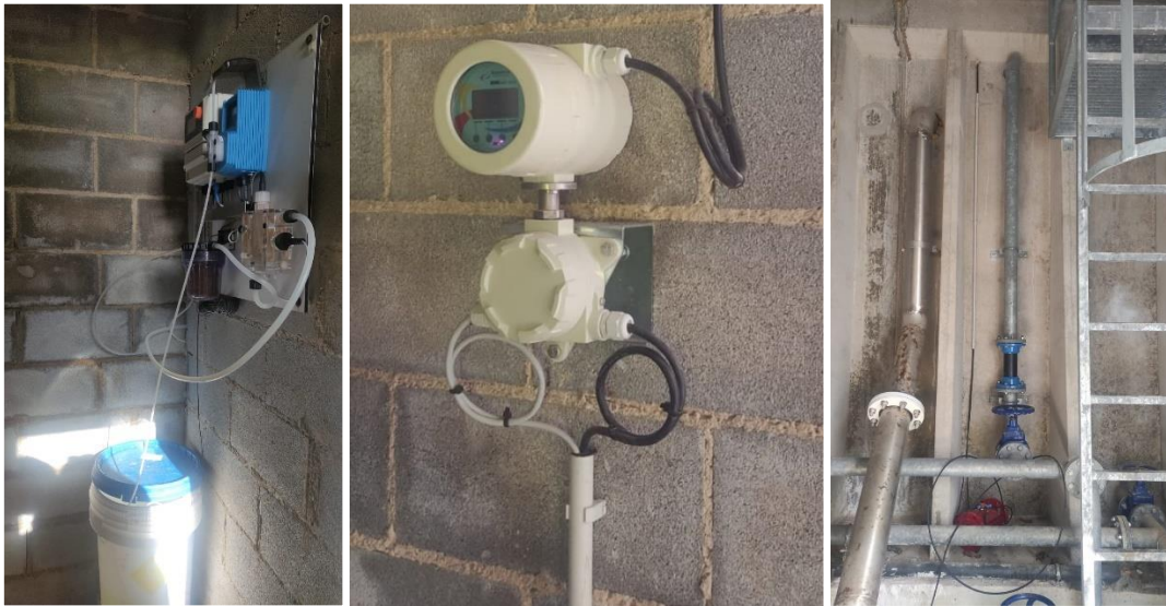
Figura 54. Cloración y analizado (izq.) y cabezal contador salida (centro.) y tubería entrada (dcha.)
