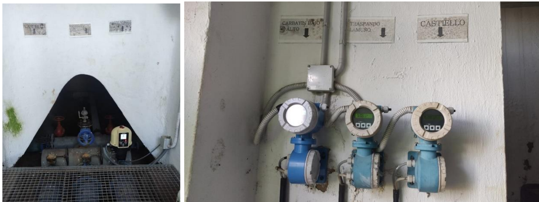
Figura 69. Conducciones distribución y contadores salida Depósito Piqueru
