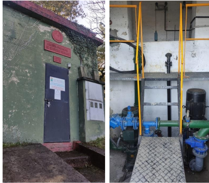
Figura 78. Exterior e interior depósito Cerezales
