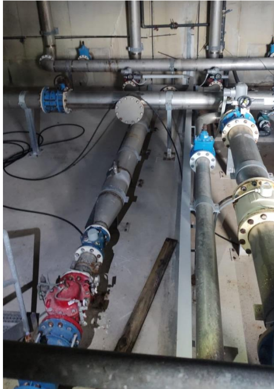
Figura 66. Tuberías de entrada y reparto de agua depósito Cotorbán
