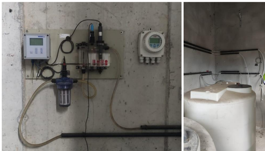
Figura 61. Analizador en continuo (izq.) y bomba de dosificación hipoclorito robada Granda II
