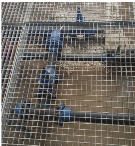
Figura 51. Conducciones de entrada de agua
