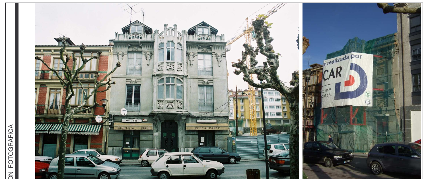
Vistas de la fachada principal a la C/ Florencio Rodríguez antes y después de la demolición.
