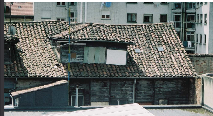
Faldón norte de cubierta, con casetón lateral, a interior de manzana. Se distingue la parte alta del frente trasero.
