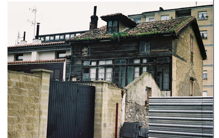
Vista de la fachada posterior donde se aprecia el mal estado de la galería y el cerramiento de bloque de la parcela 12.
