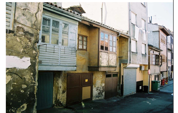
Fachada posterior, a C/ Pelagos, donde se aprecia el estado de degradación reinante.
