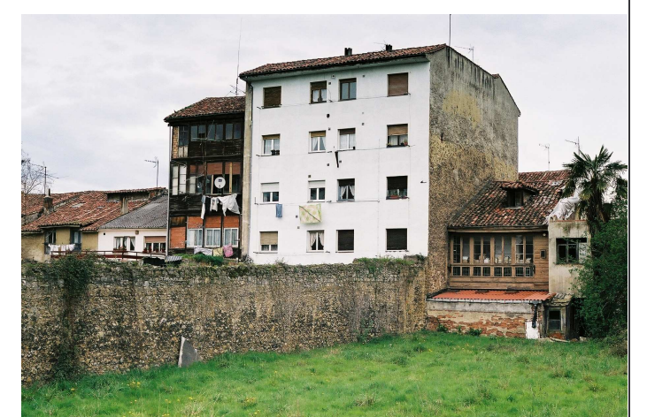
Vista de la fachada posterior, donde se aprecia el estado ruinoso de la galería.
