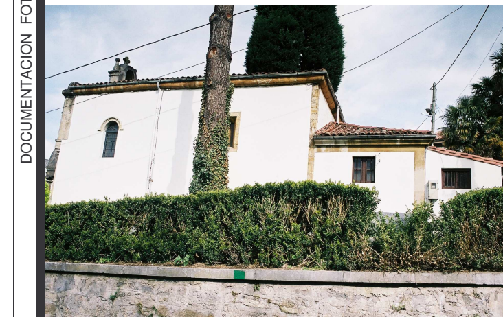
Fachada lateral sur. (Se aprecia en el extremo derecho el almacén adosado)
