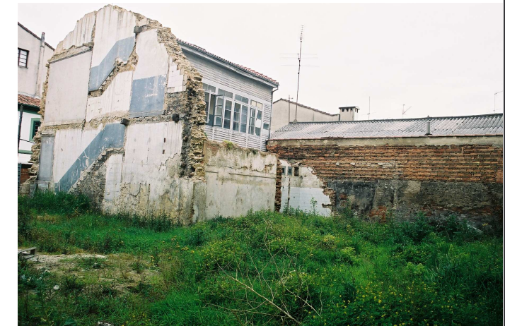
Vista de la fachada posterior tomada desde el suroeste. En primer término, el muro medianero, soporte común al edificio catalogado y al demolido.
