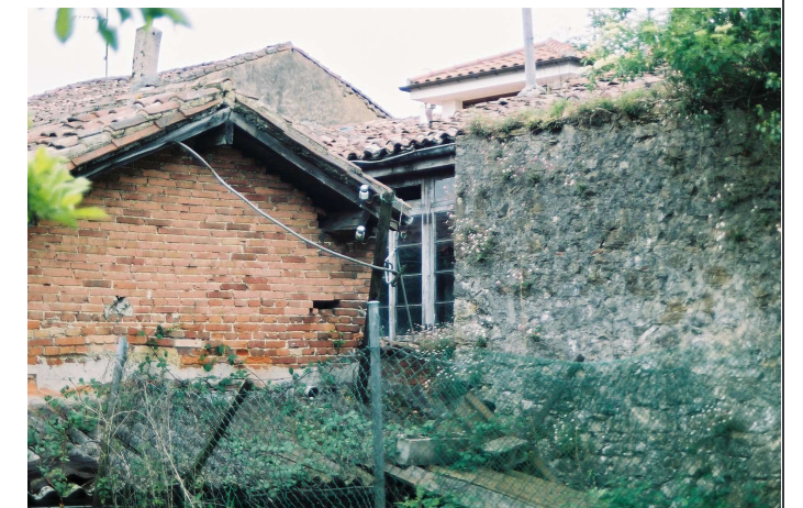
Vista desde el interior de la manzana, donde se observa un fragmento de la galería que remata la fachada posterior.
