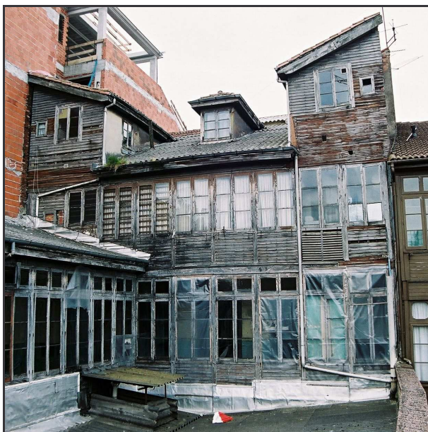
Fachada posterior, en una imagen tomada en junio de 2003, antes de la demolición del edificio.
