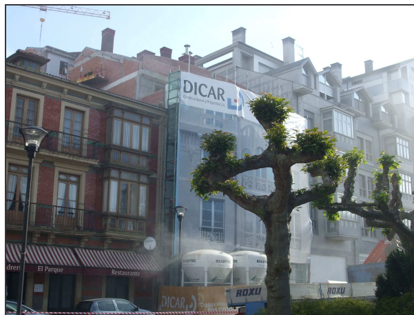
Estado actual (mayo 2008), tras la demolición del edificio original, excepto la fachada delantera, y en fase de construcción el nuevo edificio adosado tras ella.
