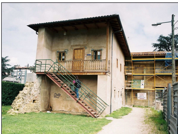
Vista del ala oeste del palacio, en una imagen tomada en abril de 2002, durante las obras de intervención realizadas por la Escuela Taller.
